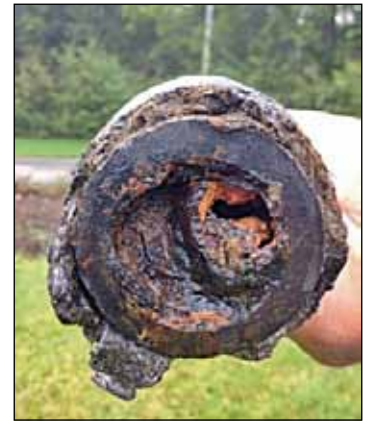
udfældninger, som vist på billedet.
