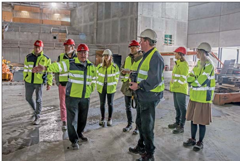
Bestyrelsesformand Bent Frank forklarer om styrken i gulvet i arenaen, der er forberedt for afholdelse af svømmestævnerne og til vægten af de mange tons, som vandet i bassinerne vejer.
